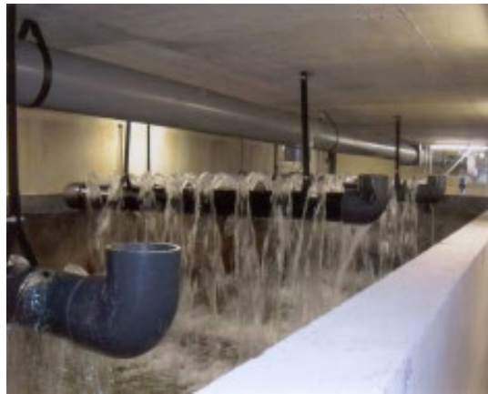
Figure 2 : Stripage par cascades d'eau (source : ARS Côte d'Armor, mai 2017)
